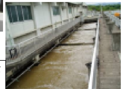
下水にバクテリアを入れて汚れを分解する「エアレーションタンク」
